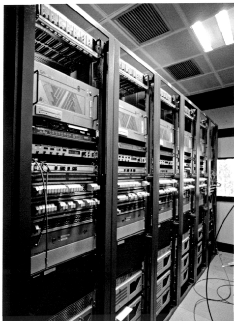
La sala con le macchine per la messa in onda: ogni colonna corrisponde a un canale
